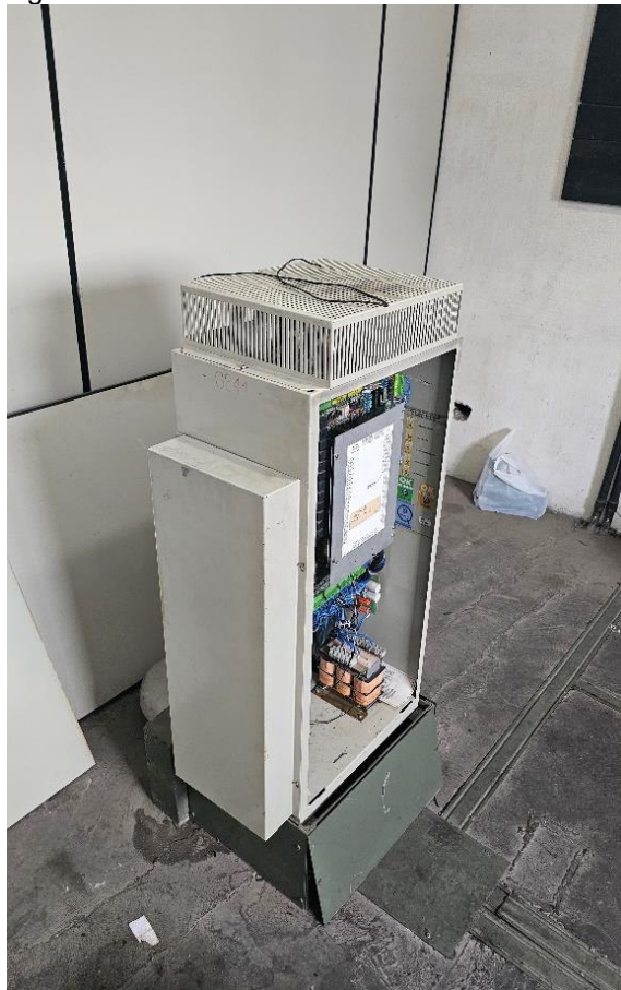
Figura 14 - Sistema elevador existente
