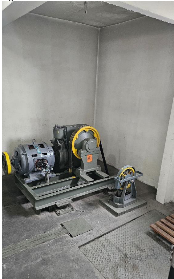
Figura 15 – Motor elevador existente
